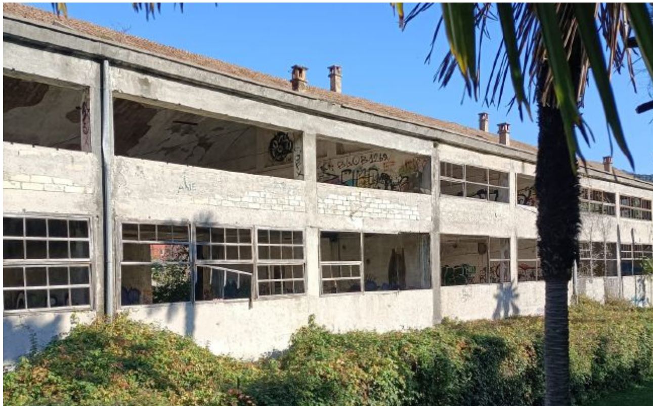
L'area Una veduta lato sud dei ruderi del vecchio edificio che sarà abbattuto per far posto a due palazzine e a un parco
